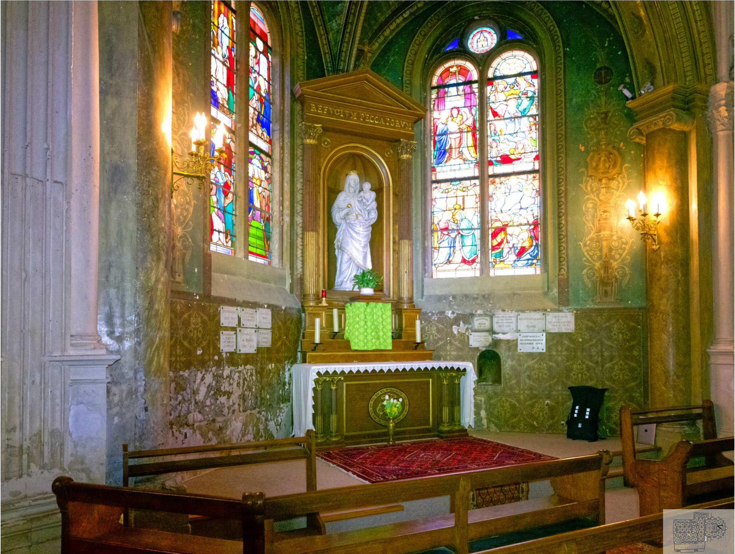
Ci-contre Illustration 1 Vue de la chapelle mariale avec ses décors encrassés et craquelures dans les soubassements SOA 2022
